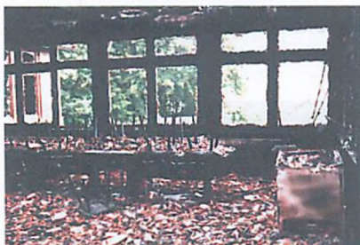
Nebenzimmer Total Zerstört. Nur noch Schutt und Asche.
